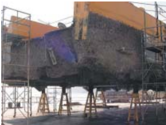
Photo. 3 損傷状況写真1
